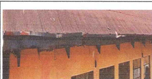
Foto 4: una parte de la costanera que se cambiara en deterioro
