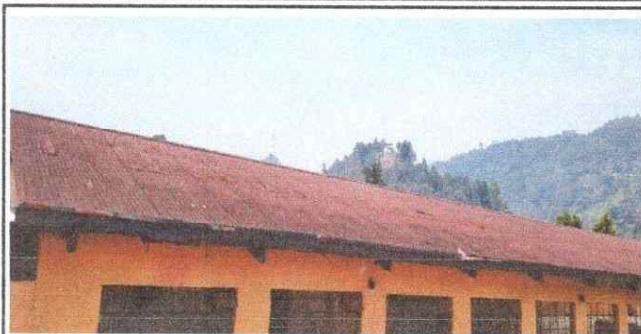
Foto 1: Así se observa las laminas en mal estado
