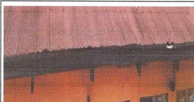
Foto 3: las laminas y canales en mal estado
